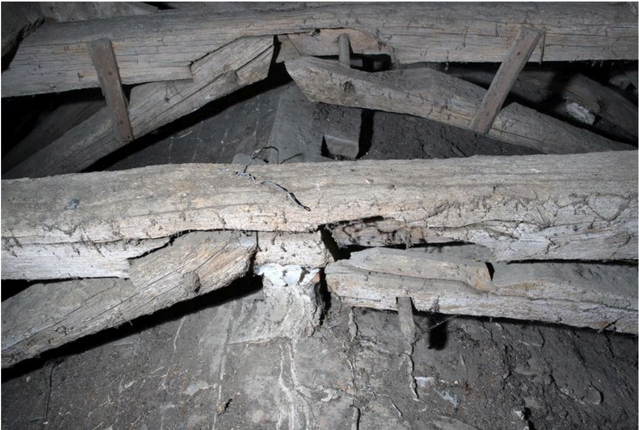
Charpente du chœur, 8e et 9e fermes, côté ouest : détail d'assemblage entre le faux entrait et les arbalétriers.
