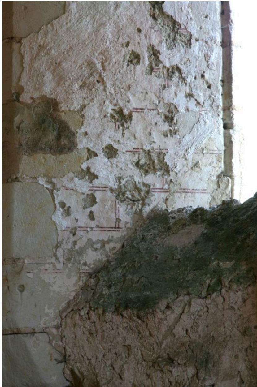
Baie droite du chevet : vestiges d'un faux appareil peint.
