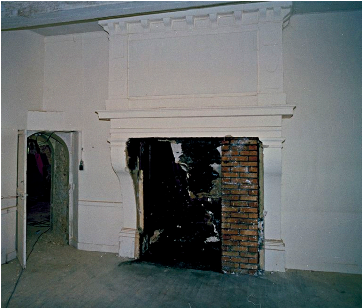
Cheminée de la cuisine (salle C du plan) du logis, détruite en 2008.
