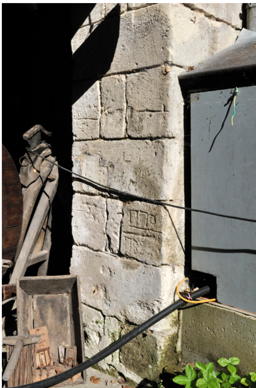
Aile nord : repères de crues du XVIIIe siècle.
