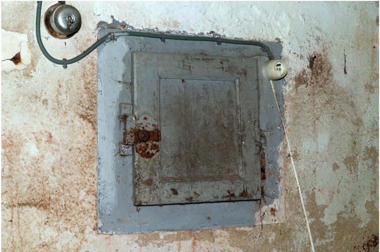
Aile sud, pièce orientale, rez-de-chaussée, mur nord, détail de la niche du XVIIIe siècle.
