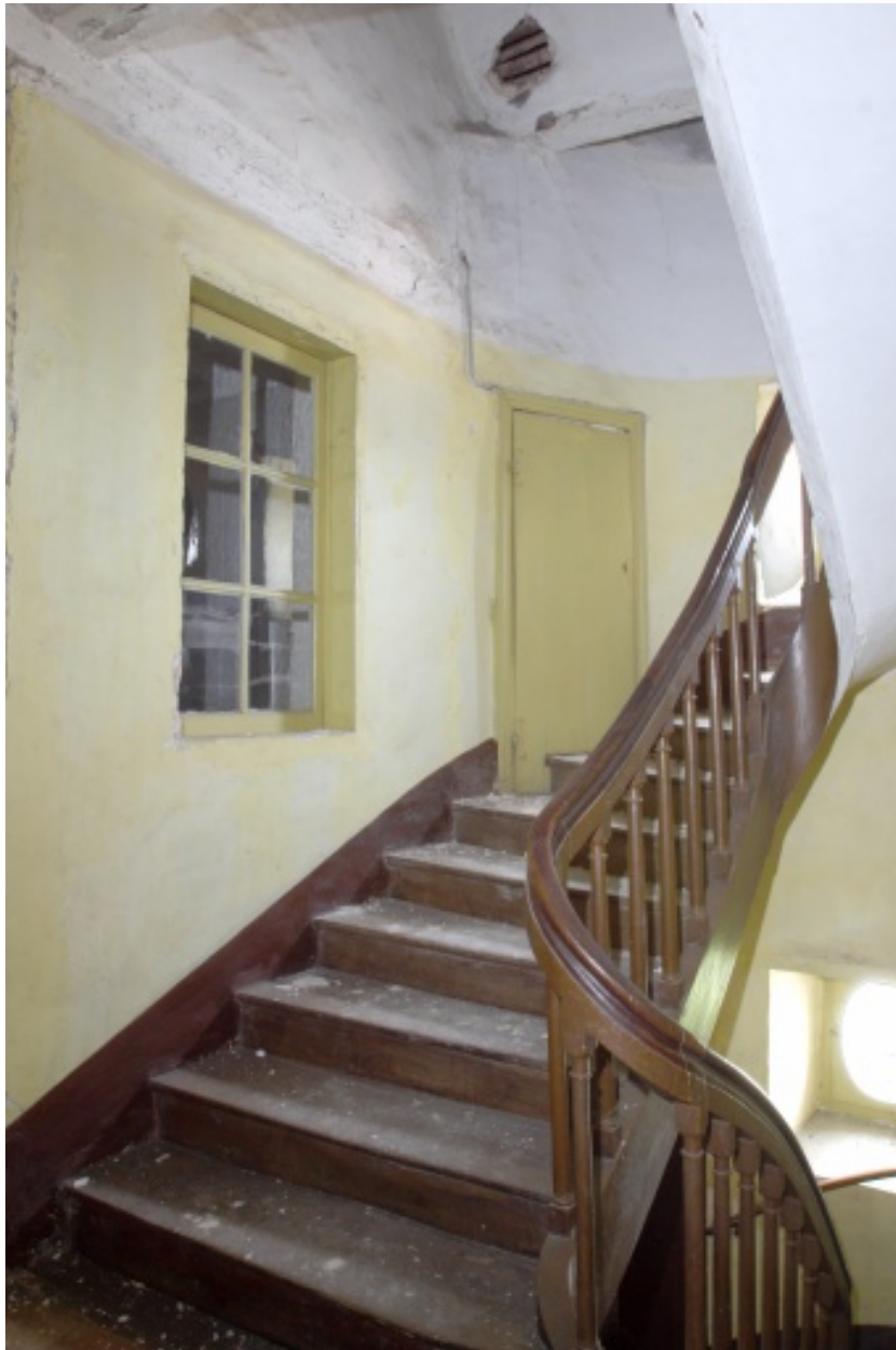
L'escalier et la porte d'accès au comble de l'appentis vus depuis le premier étage.
