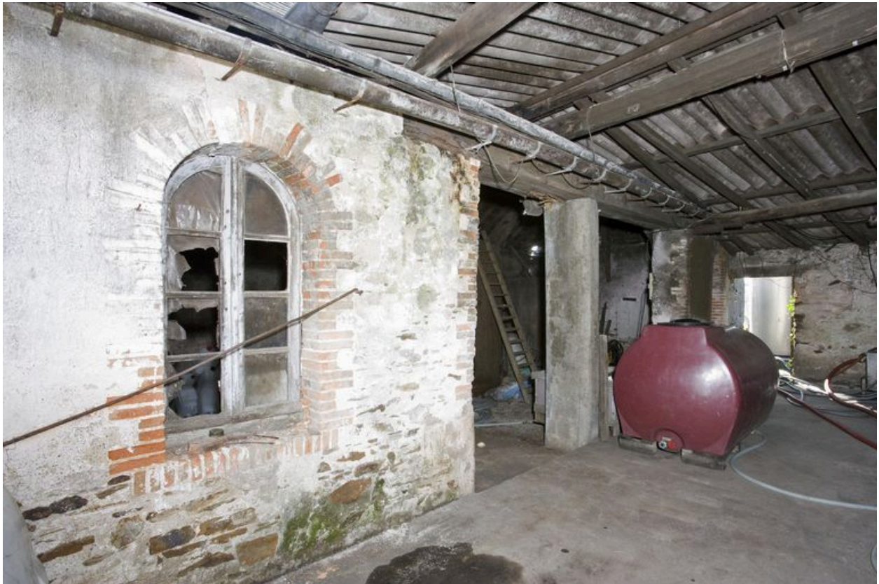
Cellier, fin 18e siècle (?), remanié au 19e siècle : façade éventrée.
