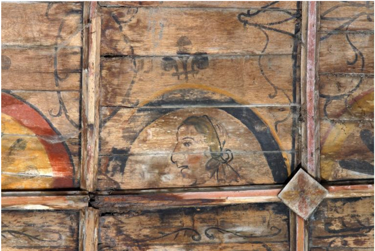
Nef, voûte, côté sud, première travée, registre supérieur : tête de femme de profil.
