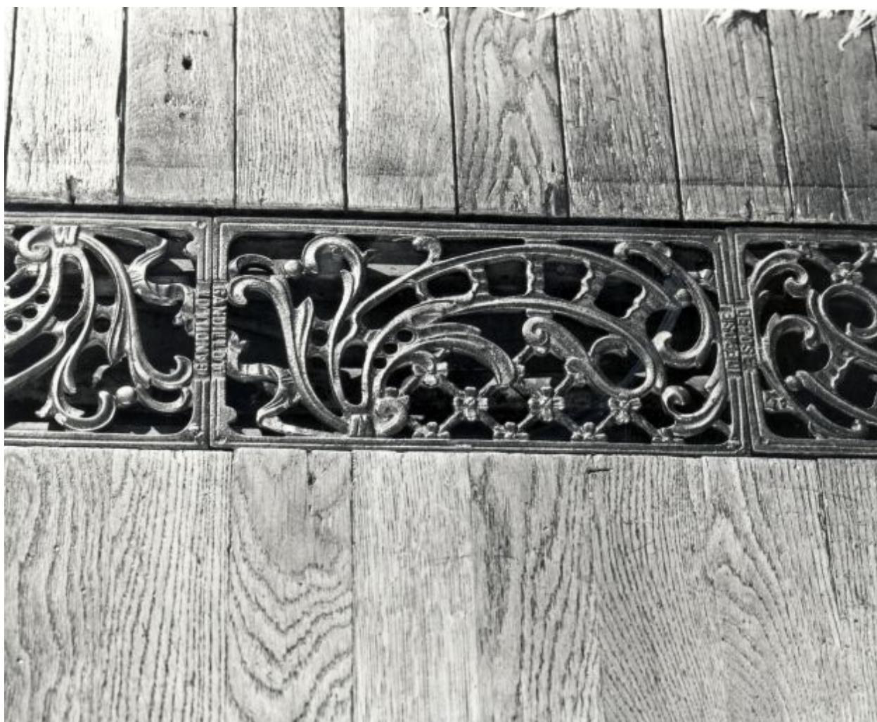
Jonction des parquets du salon et du bureau : grille de couverture d'une gaine de chauffage.
