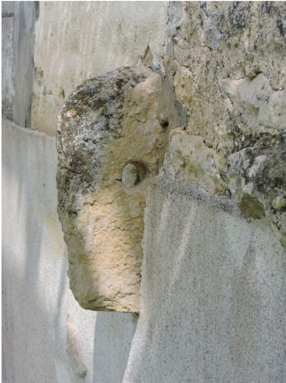
Anneau d'attelage percé dans une pierre insérée dans le mur nord du logis.
