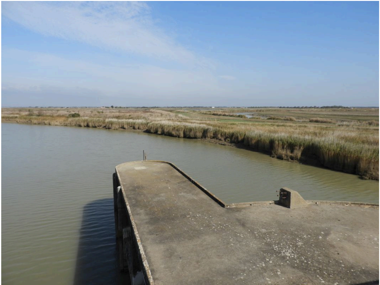
Le pont face au point d'étranglement de l'anse du Brault, vue en direction du nord.
