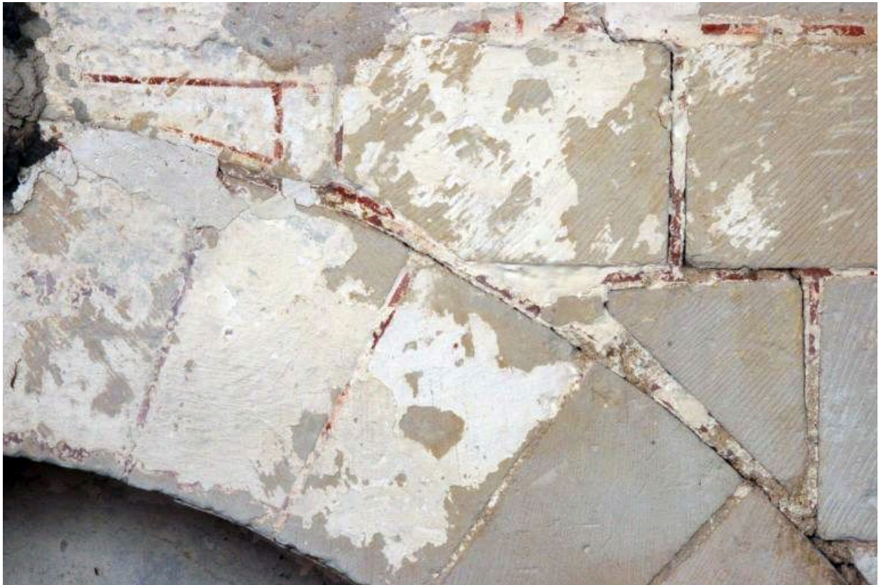
Arc diaphragme, côté chœur : trace de faux appareils.
