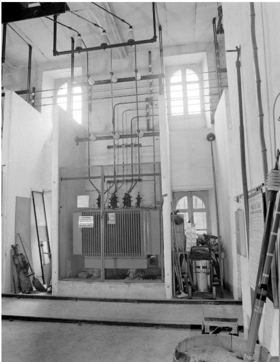
Le transformateur, situé au rez-de-chaussée de l'ancien moulin.
