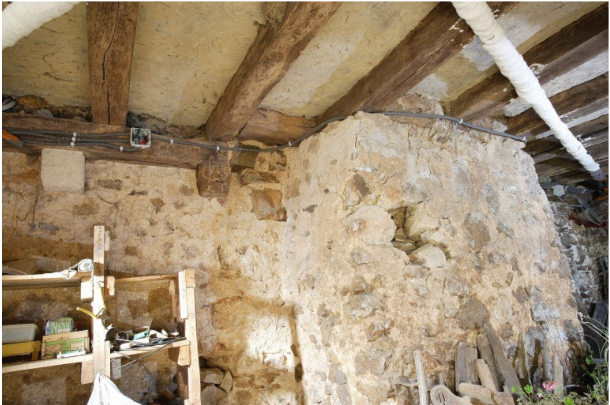
Le logis, corps central, étage de soubassement, pièce ouest, mur ouest : poutre de rive sur corbeaux et massif de soubassement de la cheminée (supprimée)
