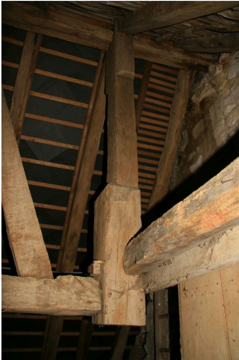
Habitation 3, pignon est : charpente à sous faîtage bas remaniée.
