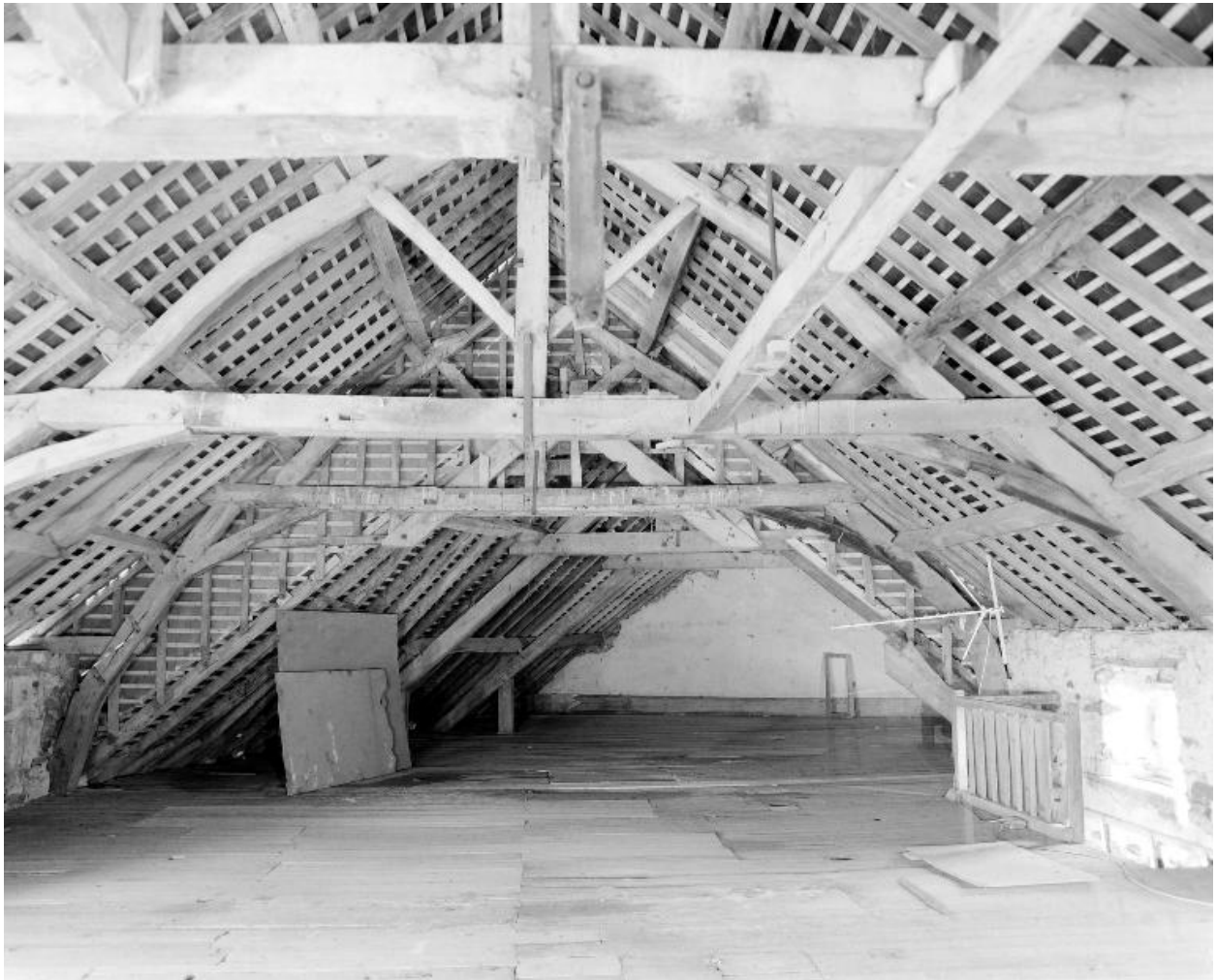
Le comble du moulin vu de l'est. Au premier plan, la charpente de la partie édifée en 1850 ; au second plan celle de la partie reconstruite en 1879.
