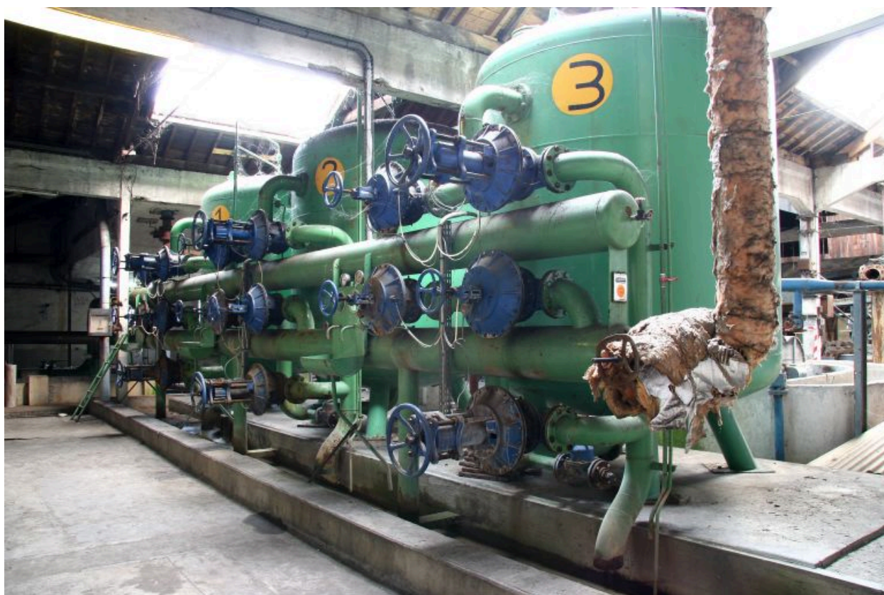
Filtres pour le château d'eau.
