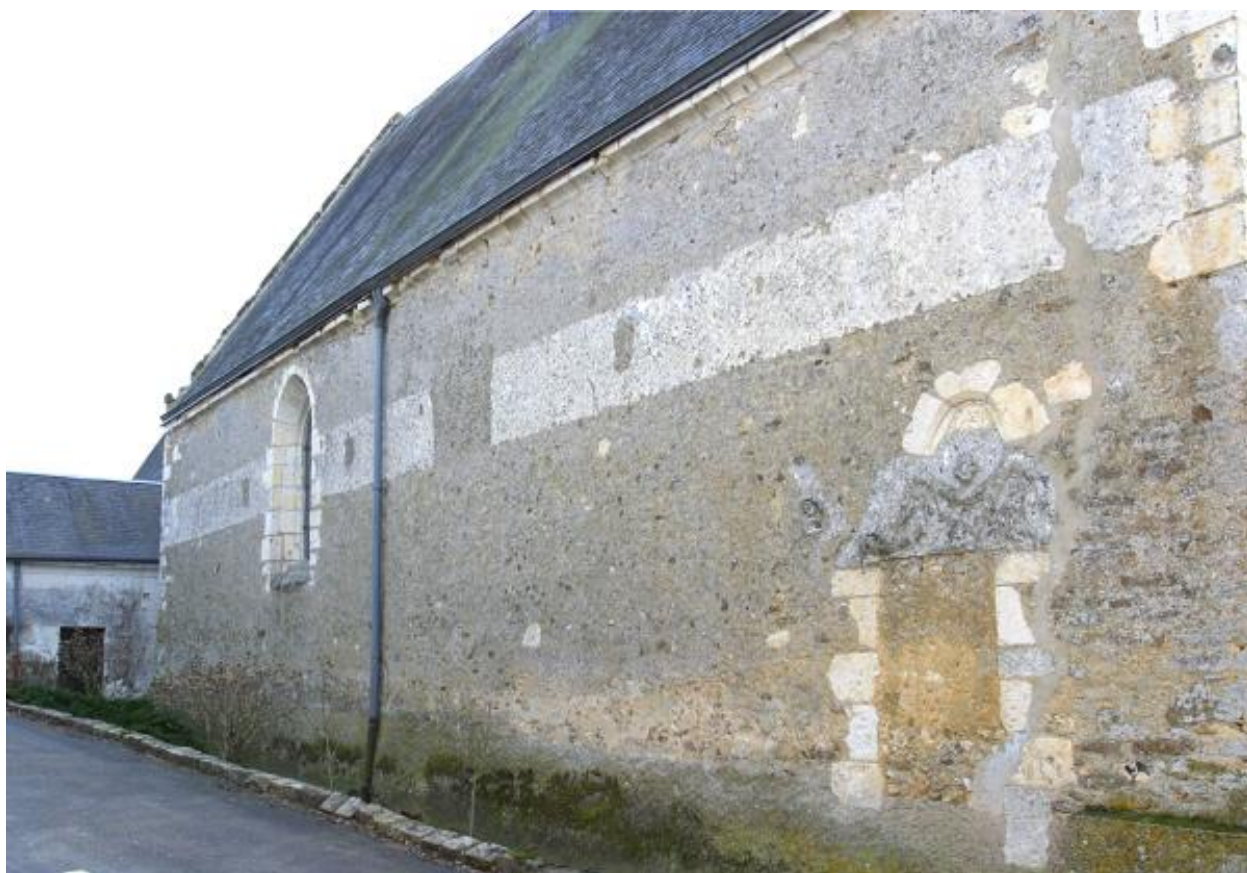
Nef, mur nord : enduit de la litre.
