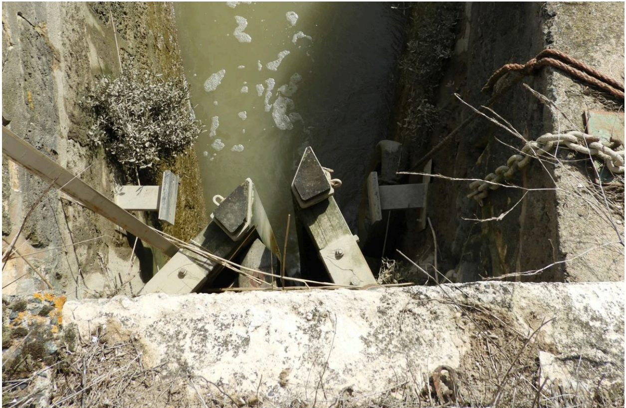
Détail de la porte côté aval : les deux vantaux de la porte vus de dessus.
