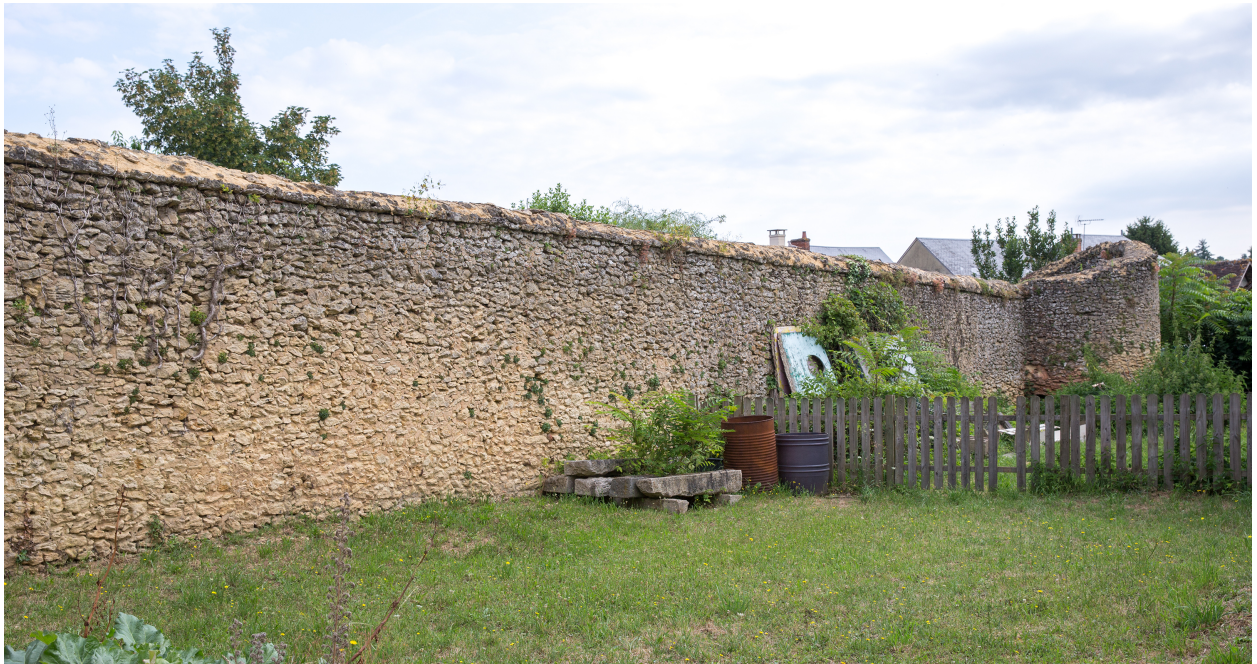
Une portion du rempart à l'arrière des rues des Vieux Ponts et Michel Beaufils (cour de l'école Sainte-Anne).
