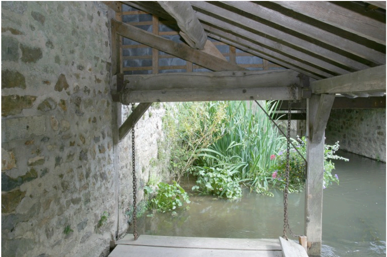
Vue intérieure depuis le sud : le plancher mobile et ses chaînes de levage.
