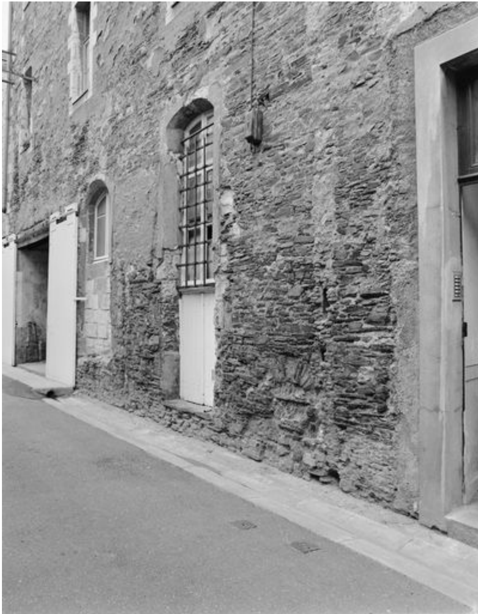
Aile orientale du cloître, élévation est sur l'actuelle impasse Grainetière : détail sur les deux baies anciennes du premier niveau.
