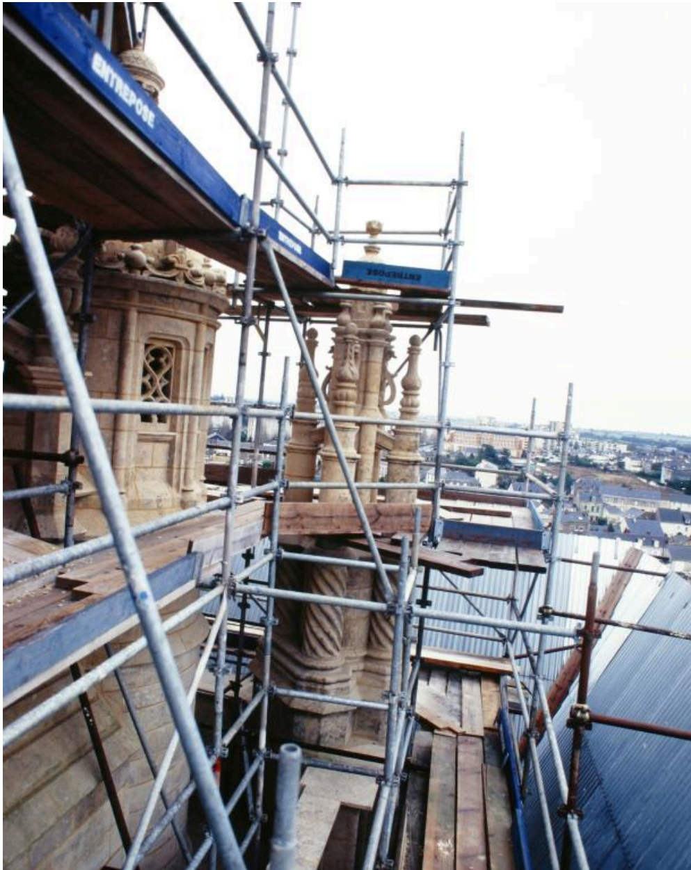
Basilique, clocher : tambour du lanternon et pinacle sud est
