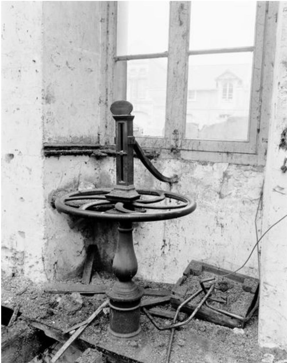
Bâtiment A ; Commande des tabliers.
