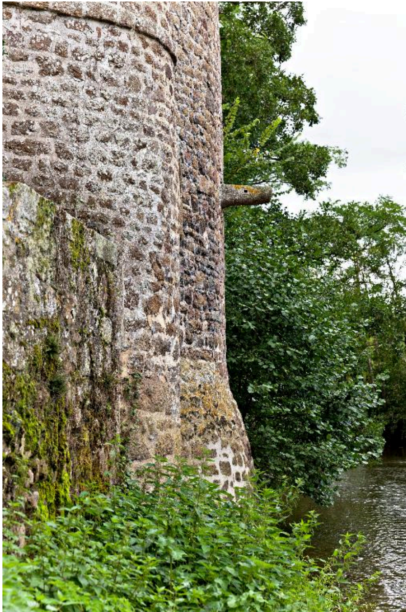
Les bases de la tourelle et de la tour nord vues depuis la rivière à l'est.
