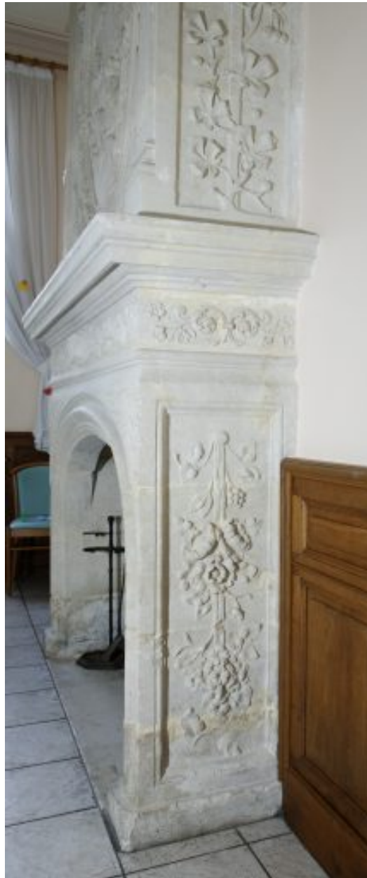
Cheminée : chutes végétales sur un côté du manteau
