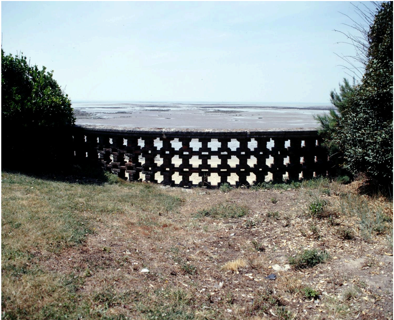
Garde-corps en brique situé en limite de propriété au-dessus de la plage.
