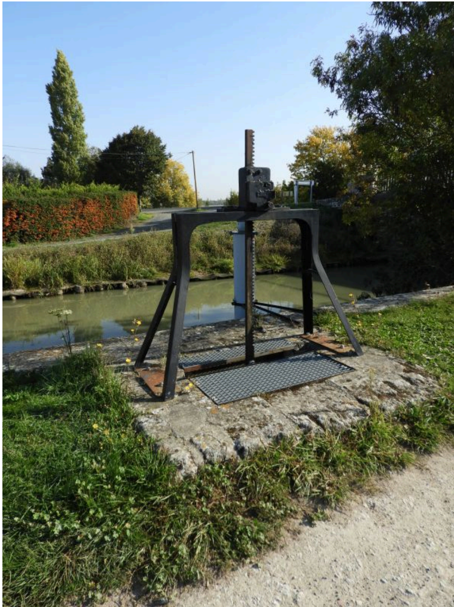
Le portique et la crémaillère au-dessus de la vanne.
