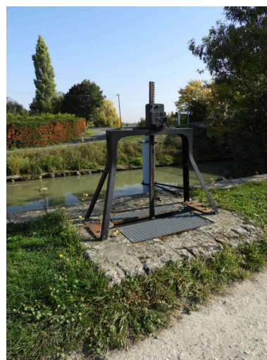
Le portique et la crémaillère au-dessus de la vanne. Phot. Yannis Suire IVR52_20188500360NUCA
