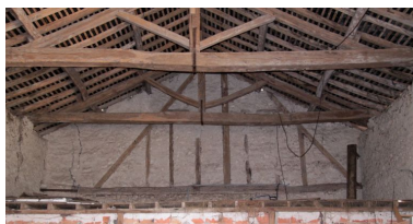
ferme du moulin (début XIXe siècle), dépendans dans le prolongement de l'habitation : vestiges d'un pignon en pan-de-bois. Phot. Jean-Baptiste Darrasse IVR52_20097200641NUCA
