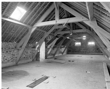
Le comble du bâtiment de stockage. A gauche, la porte d'accès à la passerelle. Phot. François Lasa IVR52_20015300427X
