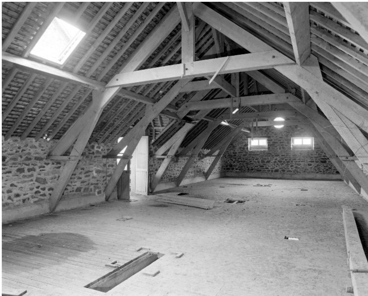
Le comble du bâtiment de stockage. A gauche, la porte d'accès à la passerelle.
