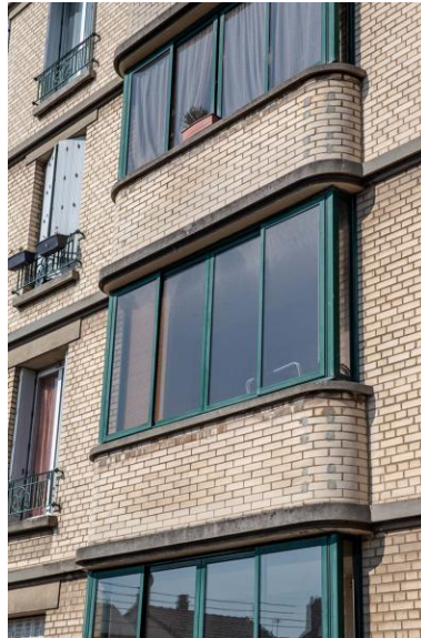
Vue des oriels sur l'aile en retour ouest de l'immeuble. Phot. Pierre-Bernard Fourny IVR52_20197200495NUCA
