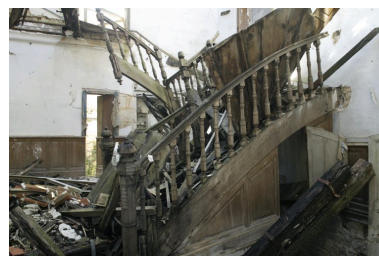
Vue intérieure montrant l'escalier effondré. Phot. Patrice Giraud IVR52_20078500049NUCA
