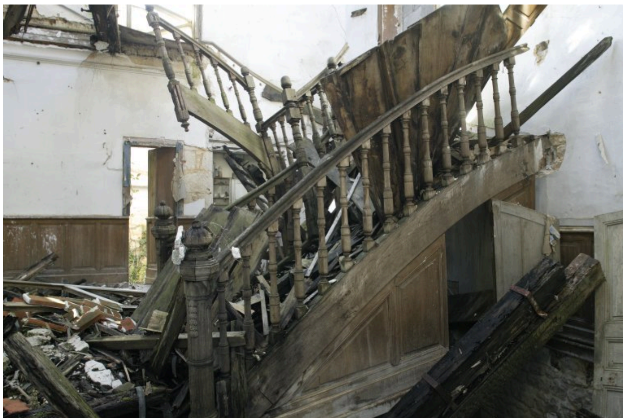
Vue intérieure montrant l'escalier effondré.
