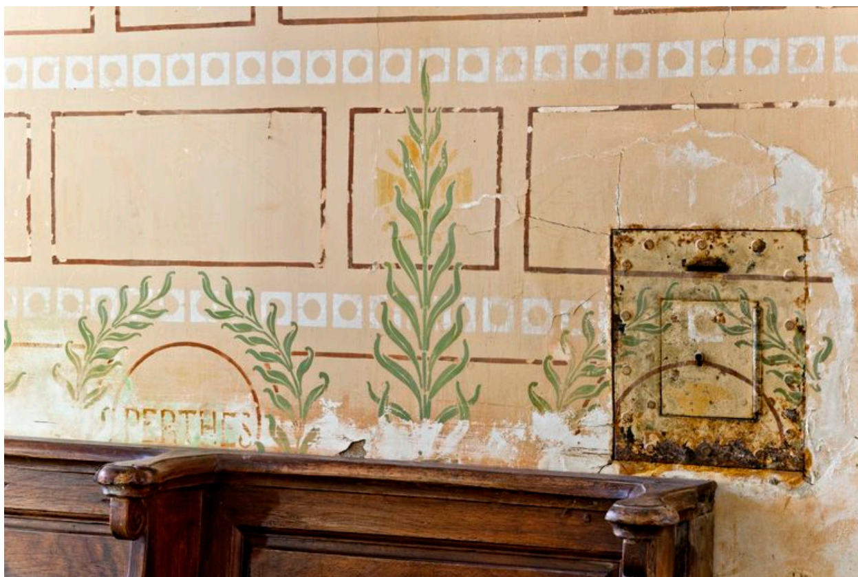
Chapelle nord, mur nord : détail du décor couvrant le tronc. Etat de conservation lacunaire.
