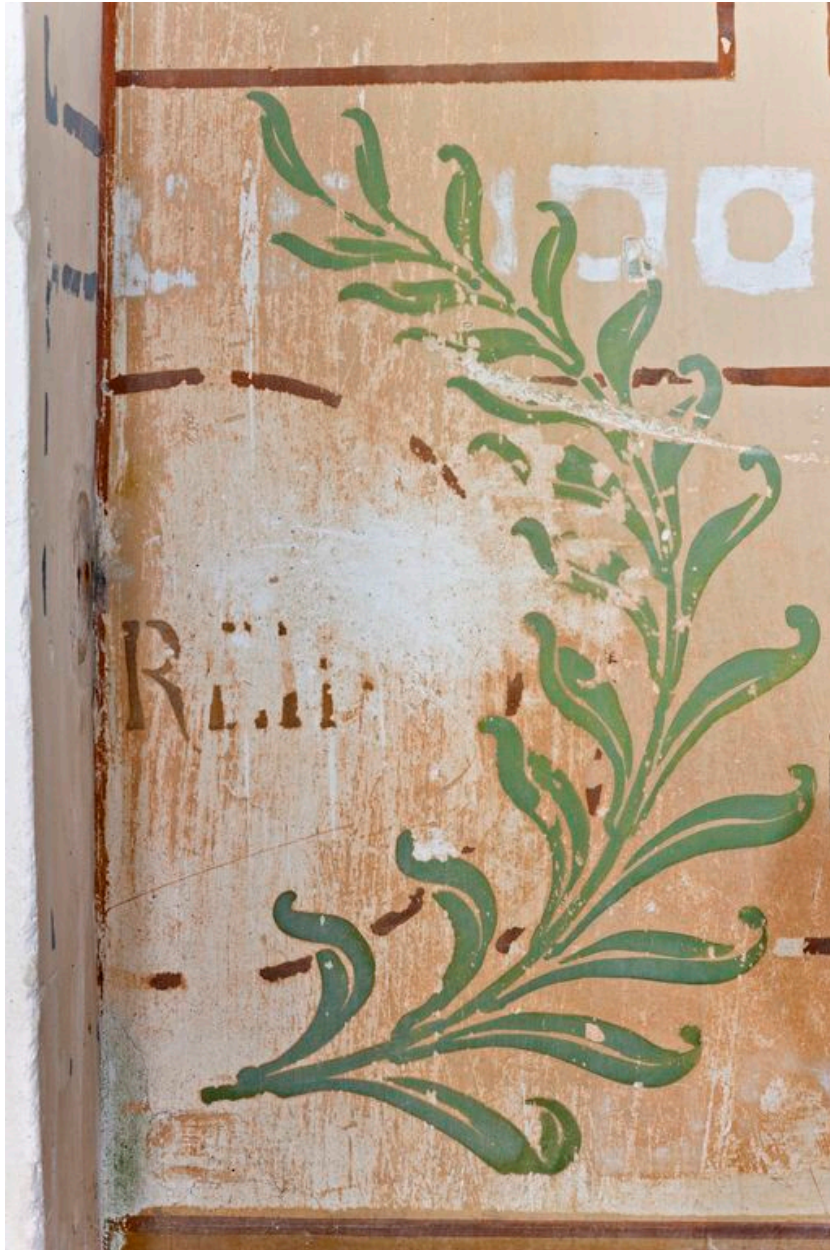
Chapelle nord. Mur nord : détail de l'état de conservation.
