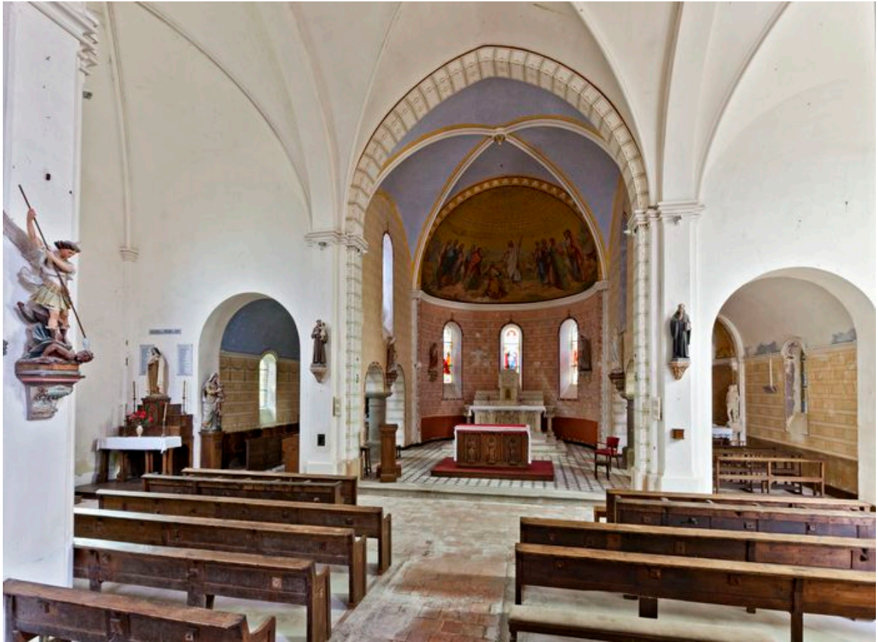
Vue de l'église depuis la partie occidentale de la nef. Le monument aux morts se développe sur l'ensemble de la chapelle nord.
