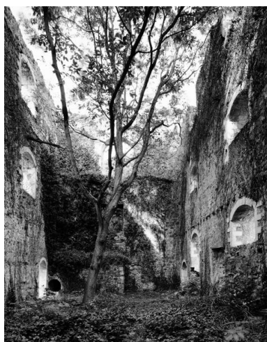
Intérieur de la grande salle du bâtiment est, vue du sud-est vers le nord-ouest, four de Sainte Barbe, Montjean-sur-Loire. Phot. Bruno Rousseau IVR52_19854901763V
