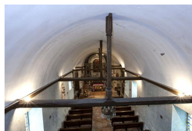
Charpente de la nef, vue depuis le premier étage de la tour clocher. Phot. Yves Guillotin IVR52_20185300157NUCA
