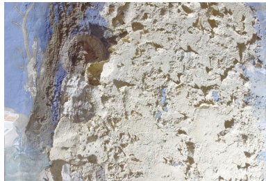
Avant choeur, mur sud. L'Agonie du Christ et saint Jean, détail d'une partie de la dégradation du support.
