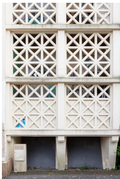
Détail du béton moucharabieh formant claustra des buanderies sur la façade principale du bâtiment A. Phot. Paul Hamelin IVR52_20227200608NUCA
