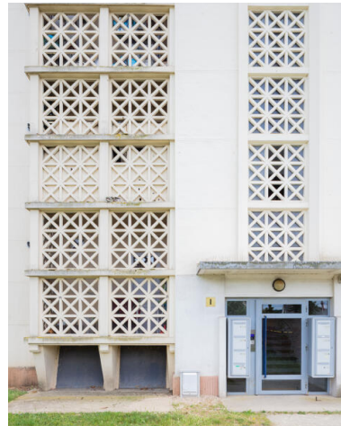
Détail du béton moucharabieh sur la travée centrale du bâtiment A. Phot. Paul Hamelin IVR52_20227200599NUCA
