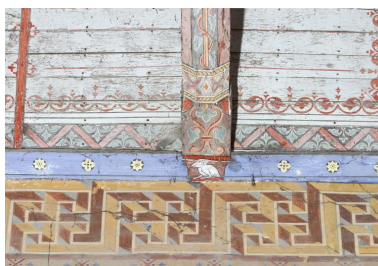
Cinquième ferme de la charpente, extrémité sud de l'entrait. Décor d'animal fantastique et accompagnement de motifs d'inspirations géométrique et végétale. Phot. Patrice Giraud IVR52_20037200097NUCA
