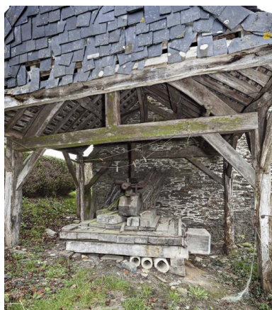
Pressoir à cidre, sous une loge en bois, écart de Montoger. Phot. Yves Guillotin IVR52_20225300049NUCA
