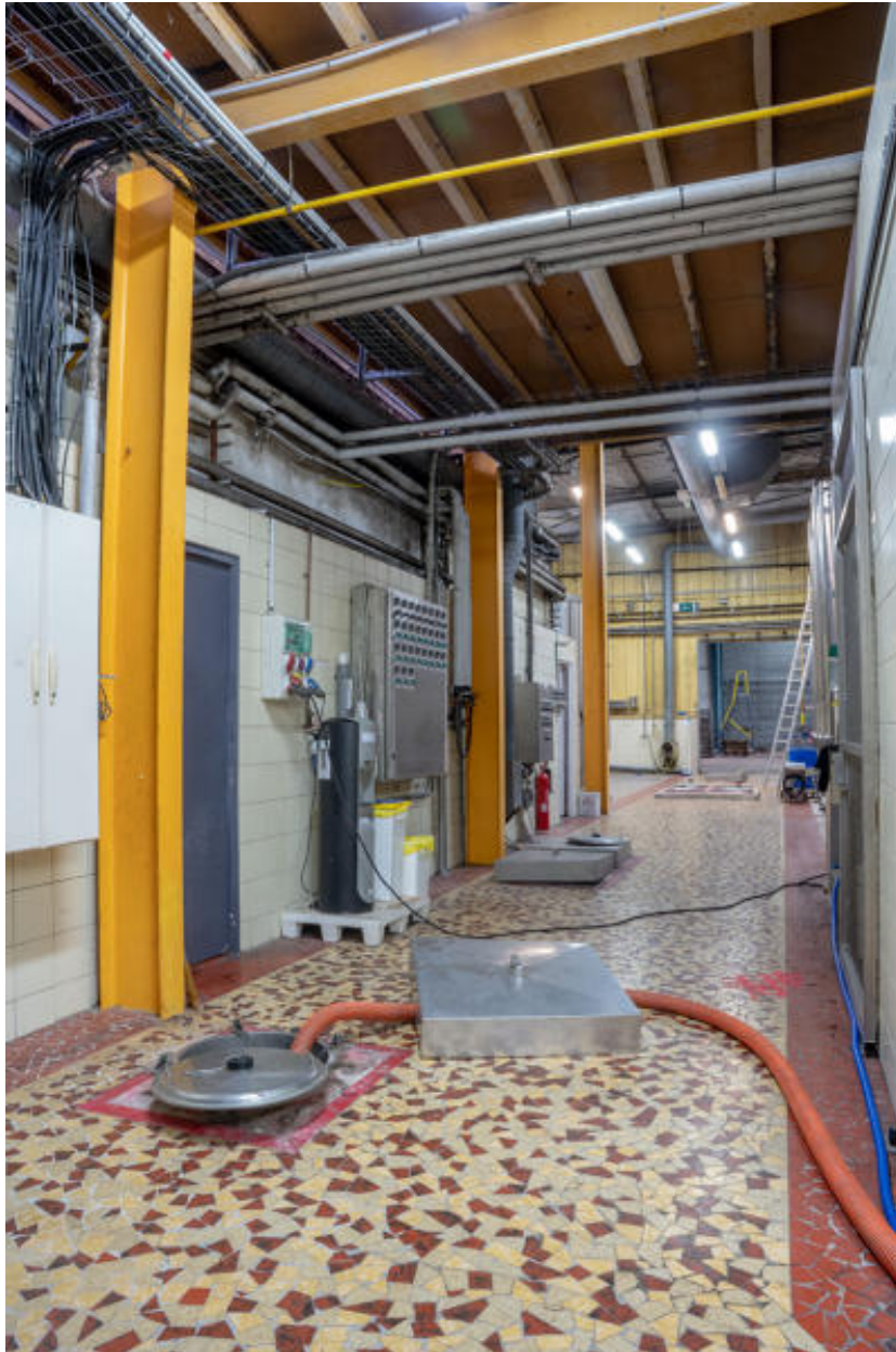
Trappes des cuves enterrées, cuves inox au second plan.
