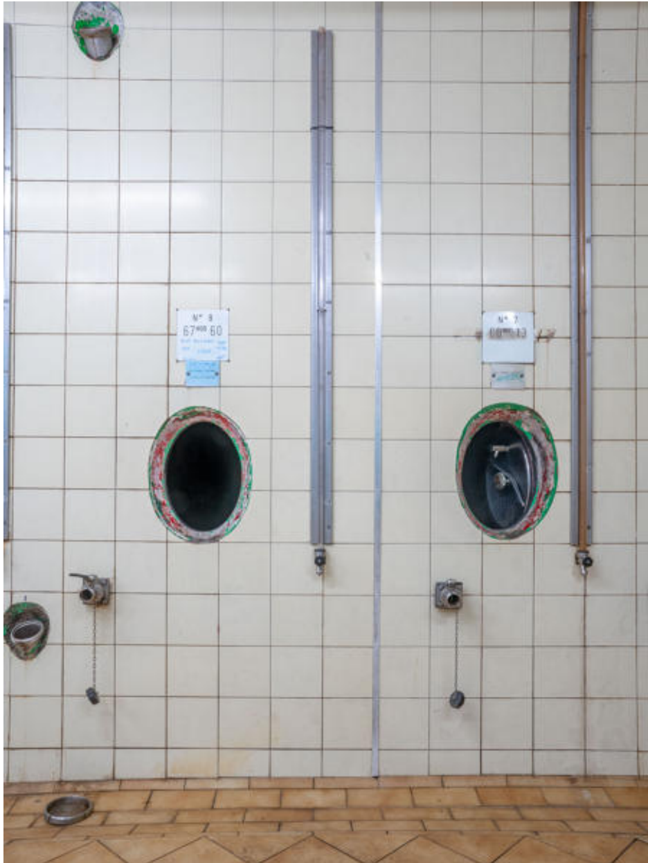
Cuves aériennes, nord-est.
