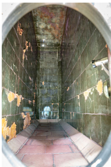
Intérieur d'une cuve aérienne verrée. Phot. Pierre-Bernard Fourny IVR52_20214401020NUCA
