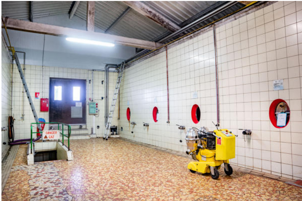
Cuves aériennes. À droite, accès aux cuves enterrées nord-ouest.
