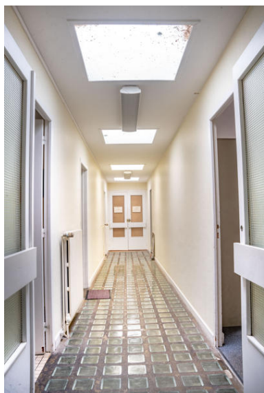
Couloir desservant les bureaux individuels et la salle des archives, au fond. Les carreaux de verre, au sol, assure l'illumination de l'étage inférieur (cuvage nord-est). Phot. Pierre-Bernard Fourny IVR52_20214401014NUCA
