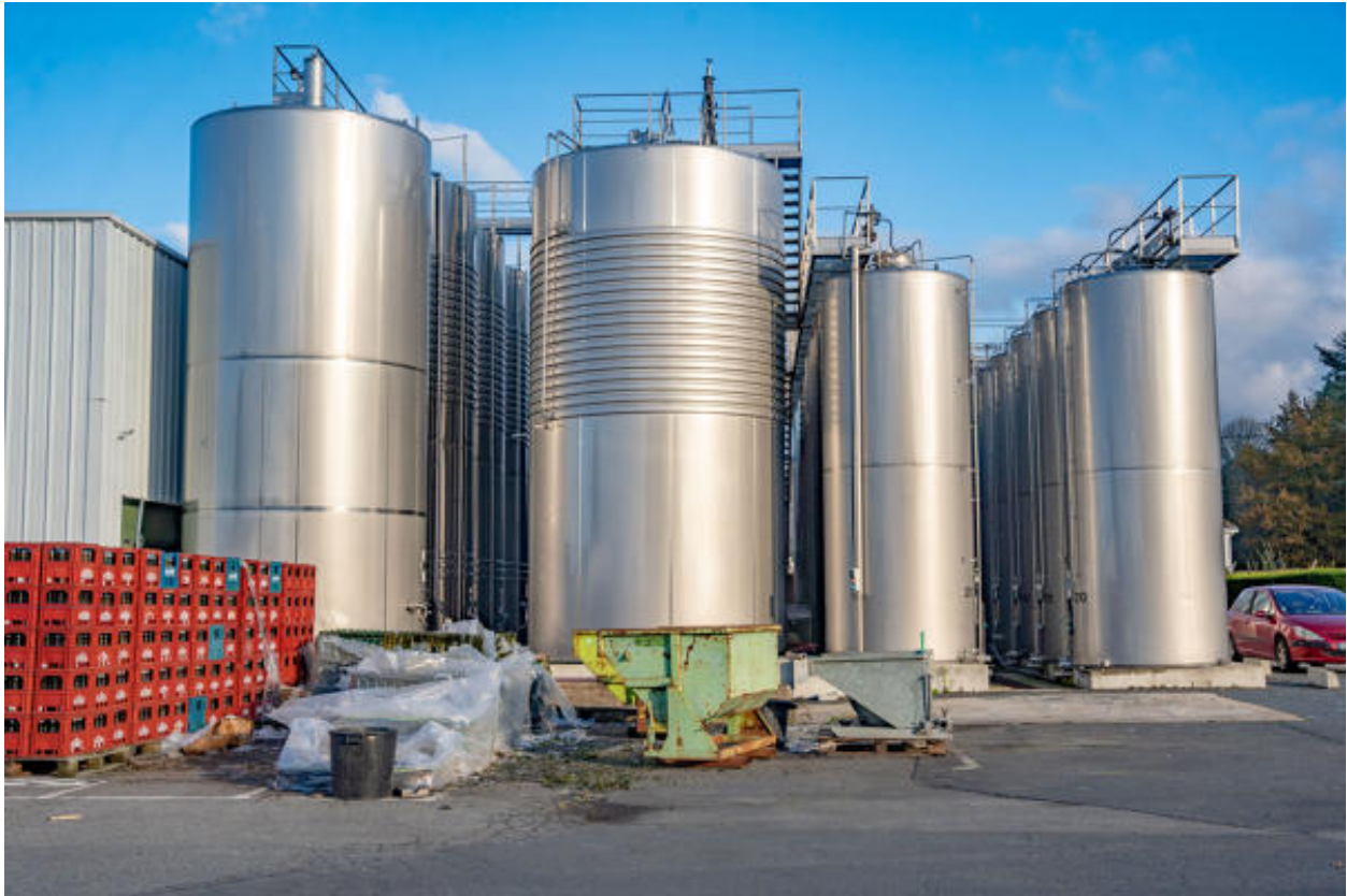
Cuves aériennes inox et leurs serpentins de refroidissement.
