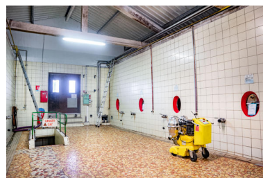
Cuves aériennes. À droite, accès aux cuves enterrées nord-ouest. Phot. Pierre-Bernard Fourny IVR52_20214401028NUCA
