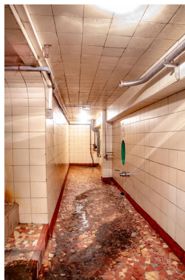
Couloir de service : accès aux cuves enterrées nord-ouest. Phot. Pierre-Bernard Fourny IVR52_20214401054NUCA
