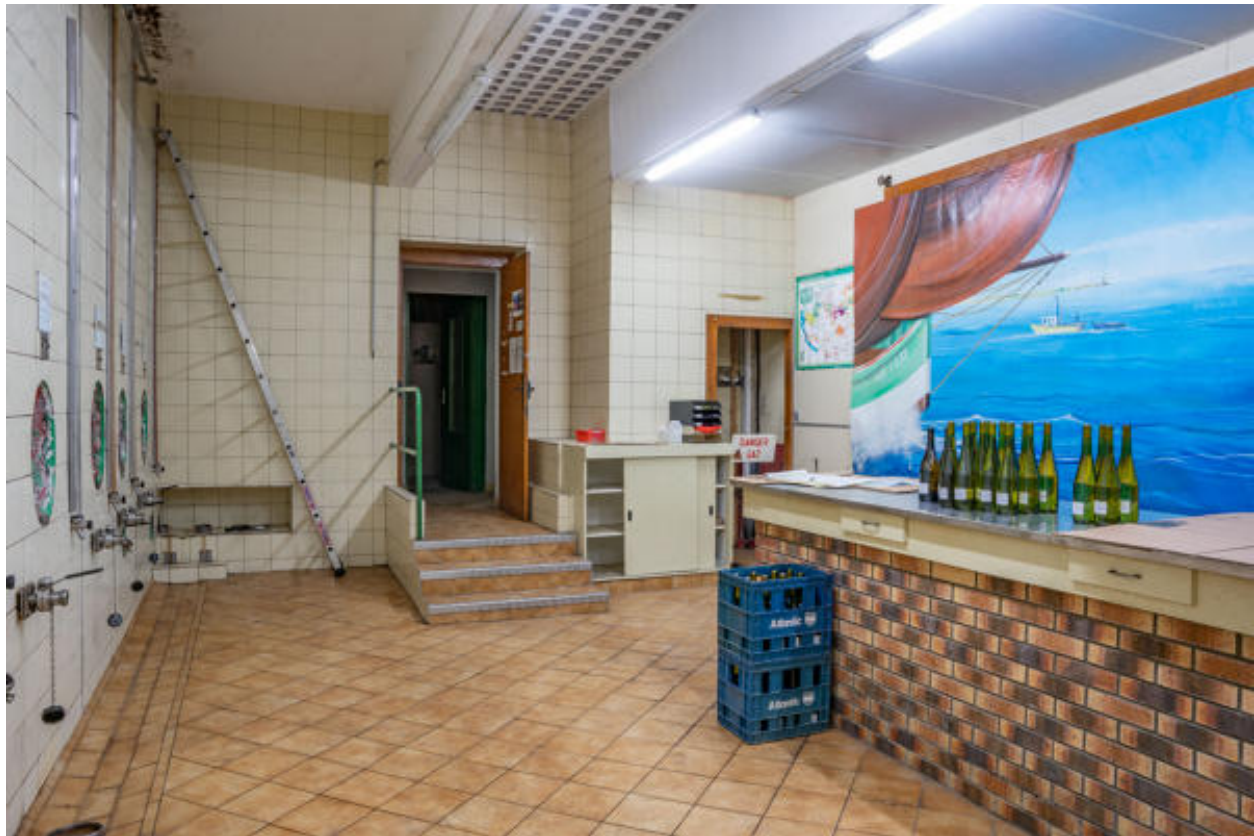
À gauche, cuves aériennes ; au fond à droite, accès aux cuves enterrées ; nord-est.
