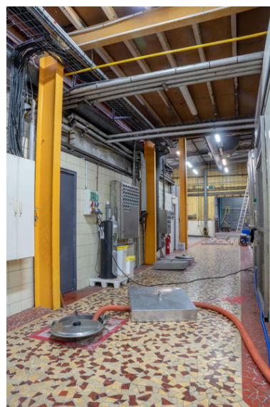
Trappes des cuves enterrées, cuves inox au second plan. Phot. Pierre-Bernard Fourny IVR52_20214401025NUCA
