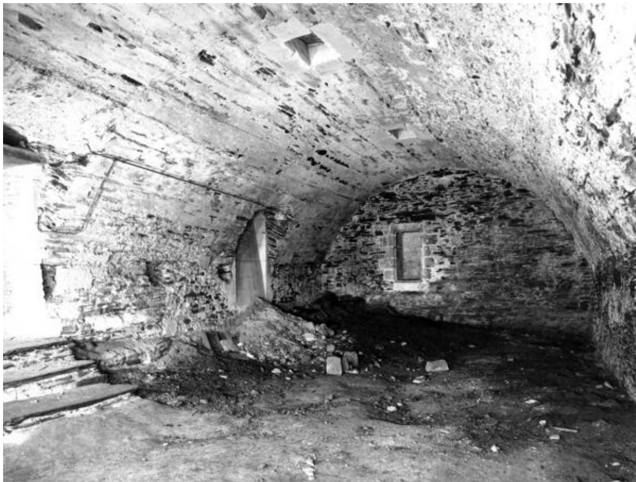
Corps de logis gauche : sous-sol, vue d'ensemble vers le mur antérieur, avec à gauche la porte vers l'escalier et un accès muré à une cave sous la cour.
