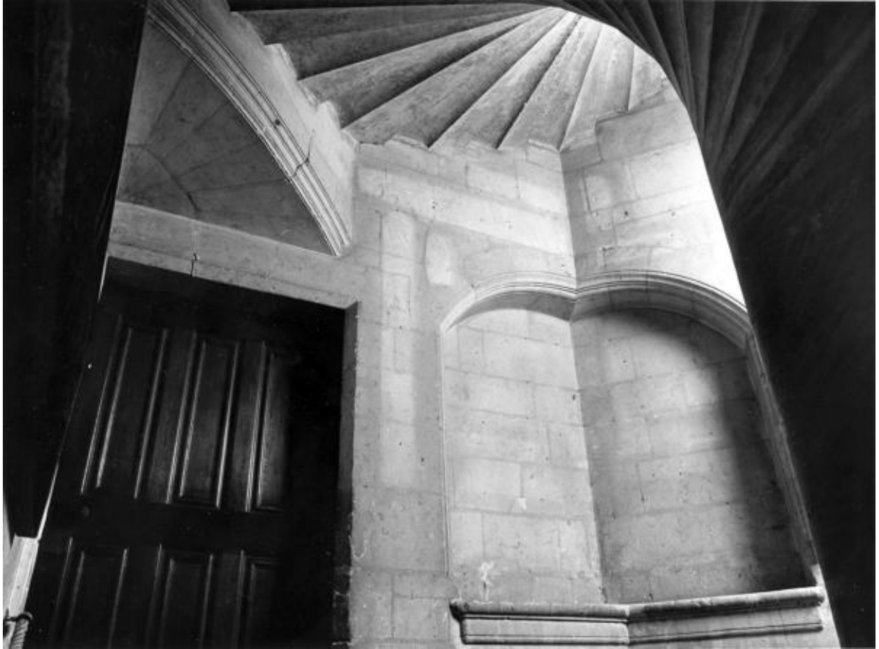
Cage de l'escalier, deuxième révolution, avec porte d'accès au premier étage du corps de logis droit.
