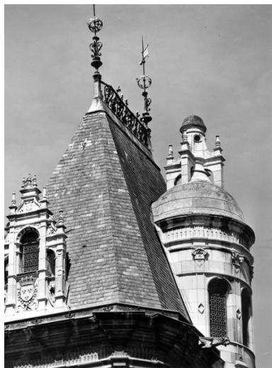
Couverture de l'escalier principal et couronnement de l'escalier d'accès à la chambre haute. Phot. François Lasa IVR52_19914901129X
