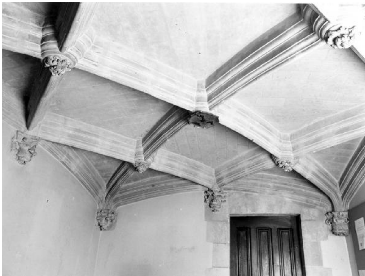
Corps d'escalier, 1er niveau, vestibule entre les deux corps : vue d'ensemble avec la voûte et la porte d'accès au corps de logis droit.
