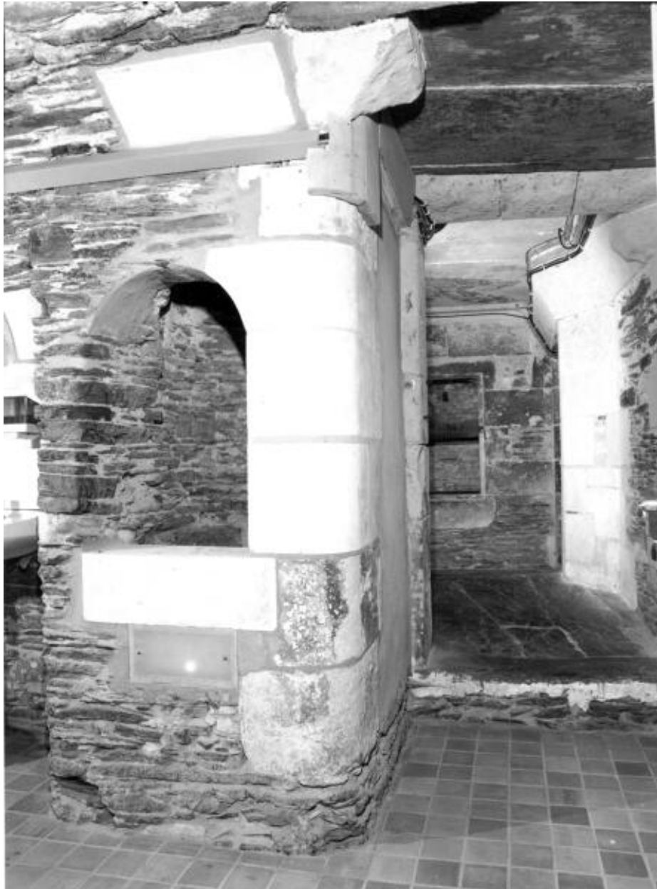
Etage de soubassement, pièce située sous le vestibule, mur antérieur : puits et accès à la cage d'escalier.
