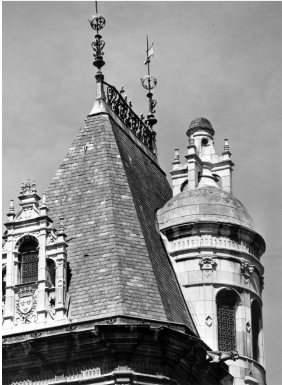
Couverture de l'escalier principal et couronnement de l'escalier d'accès à la chambre haute.
