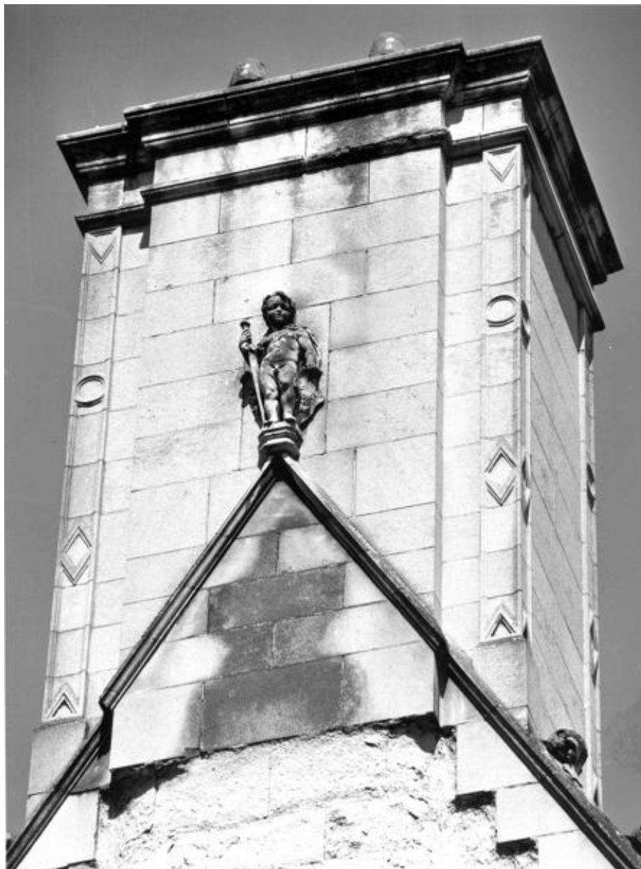
Corps de logis gauche, pignon gauche, souche de cheminée : figure d'enfant portant une épée et un blason aux armes de Pincé.
