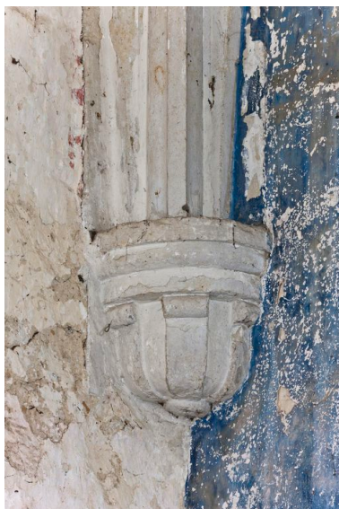
Culot antérieur gauche Phot. Yves Guillotin IVR52_20127201276NUCA
