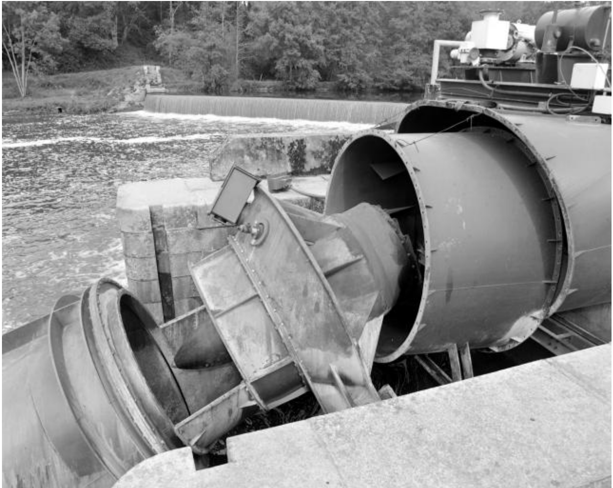
La turbine et le générateur de la centrale hydroélectrique.
