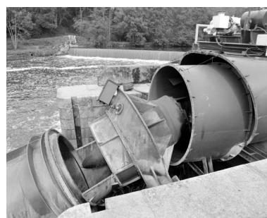
La turbine et le générateur de la centrale hydroélectrique. Phot. François Lasa IVR52_20015300569X
