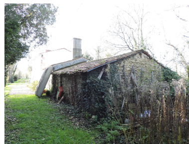
Les dépendances de la hutte, dans son prolongement à l'est, vues depuis l'est.
