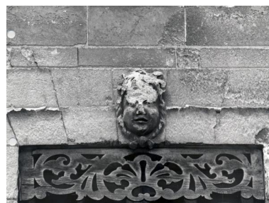
Elévation sur la rue du Canal : 1er étage, mascaron de la travée centrale. Phot. Patrice Giraud IVR52_19864900306X
