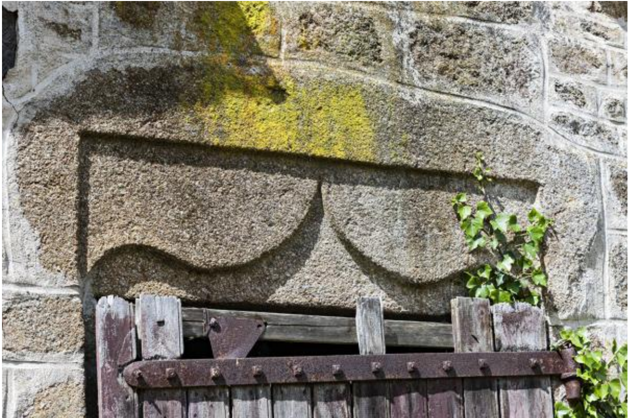
Linteau de porte de l'ancien logis
