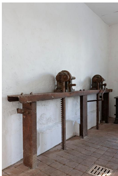
Rez-de-chaussée, partie nord, en 2019 : vannes d'amont.
