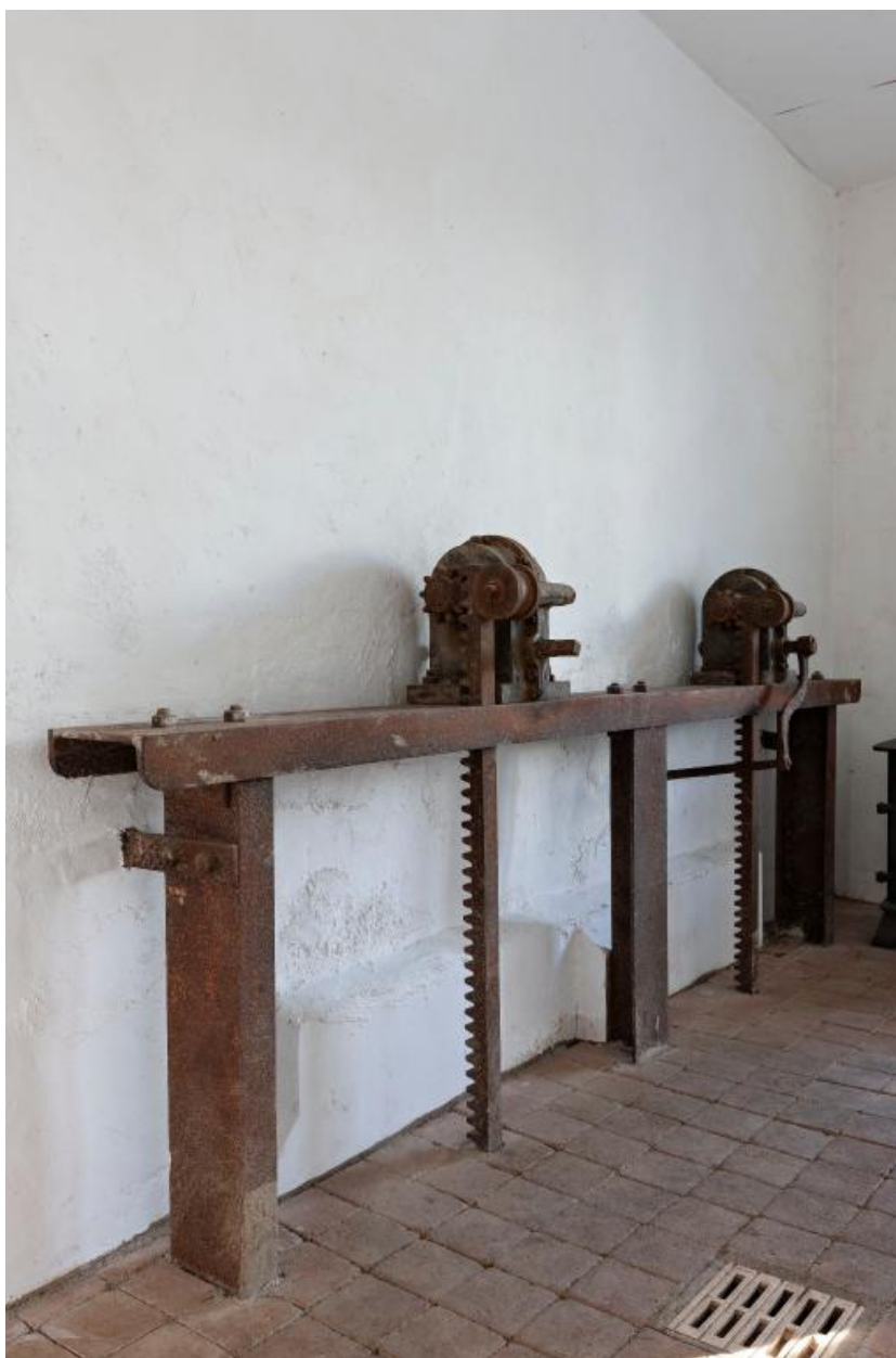
Rez-de-chaussée, partie nord, en 2019 : vannes d'amont.
