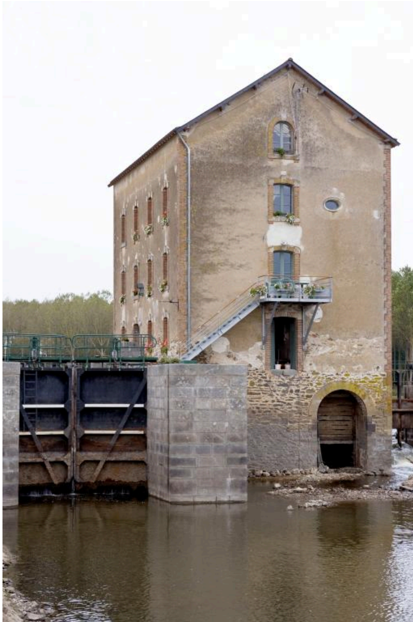
La façade sud-est (d'aval) du moulin, pendant les écoures de 2009. A gauche, la porte d'aval de l'écluse.
