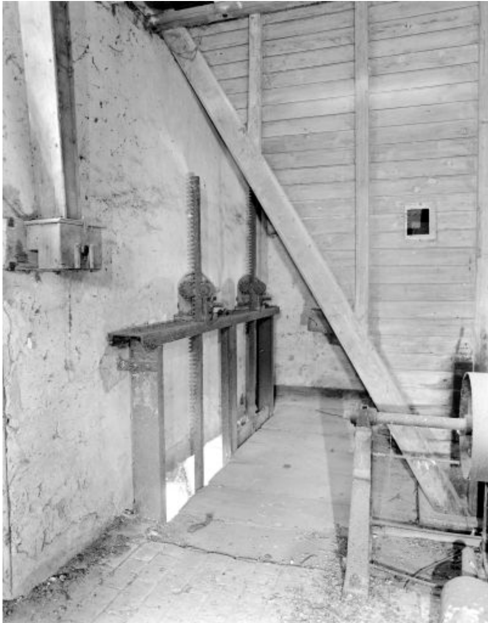
Rez-de-chaussée, partie nord, en 2002 : vannes d'amont servant à fermer et à ouvrir le coursier.
