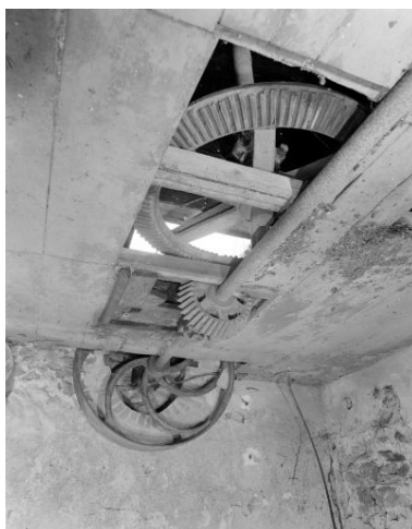
Rez-de-chaussée, partie est, en 2002 : le système de transmission des turbines, situées dans la partie aval du coursier. Phot. François Lasa IVR52_20025300736X
