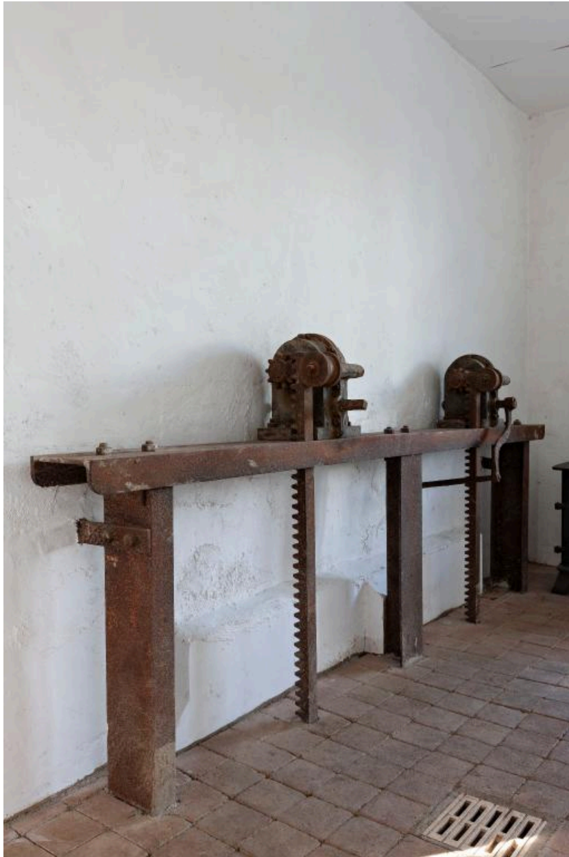
Rez-de-chaussée, partie nord, en 2019 : vannes d'amont.
