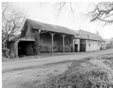
Principal bâtiment de dépendance, en 2002 : façade nord-ouest. A gauche, les remises. A droite, corps contenant l'étable à chevaux et l'étable à vaches.
