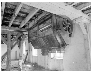
Deuxième étage, partie sud-ouest vue depuis le nord, en 2002 : bluterie-diviseur pour le remouillage. Phot. François Lasa IVR52_20025300728X
