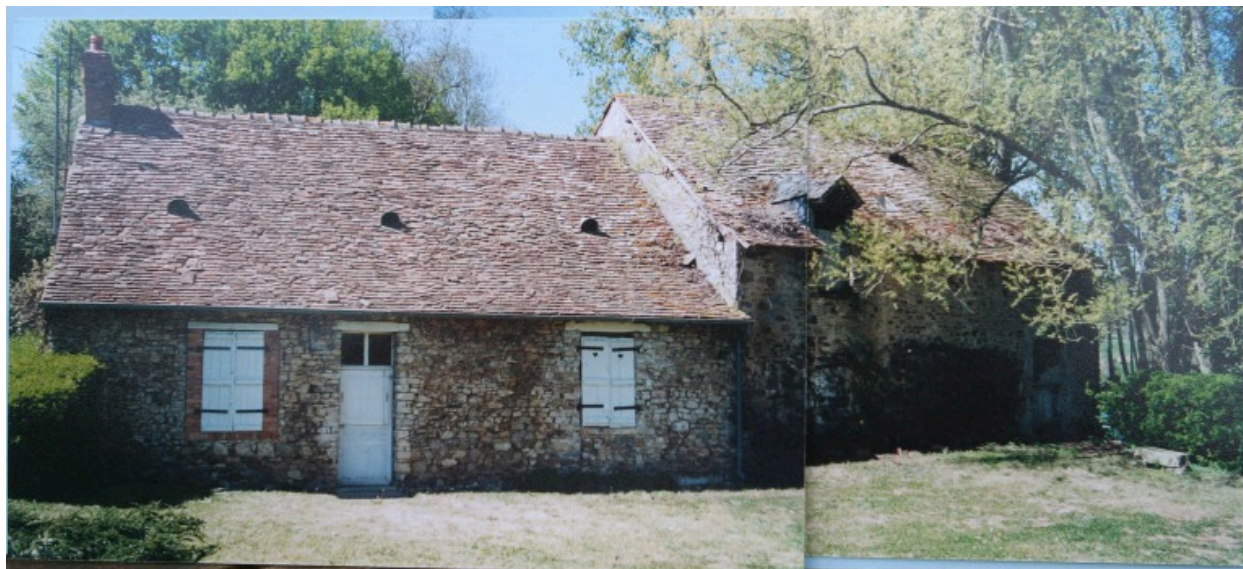
Le logis et le moulin avant les travaux. Façade principale au sud-est.
